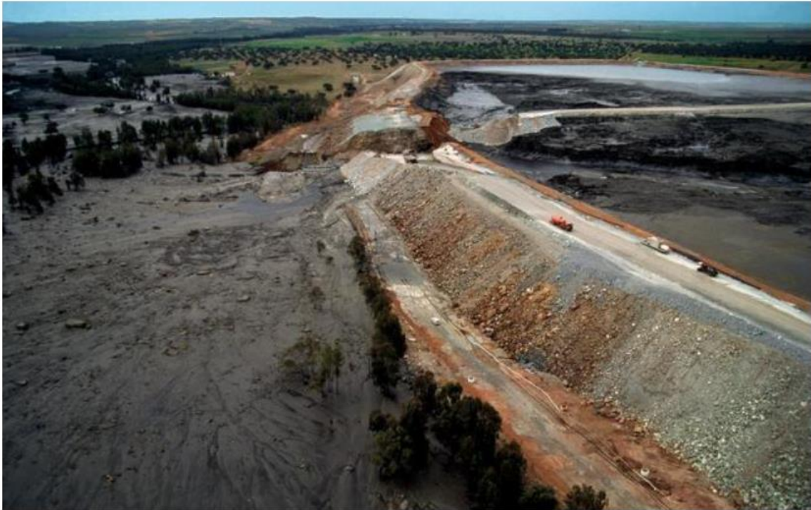
Fotografía 18: la balsa minera de Aznalcóllar tras su rotura.
