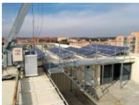
Ilustración 1. 5: Instalación fotovoltaica en Eren (León).
