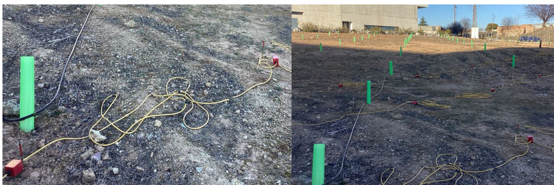
Figura. 3.13. Conexión entre electrodos y el cable.
