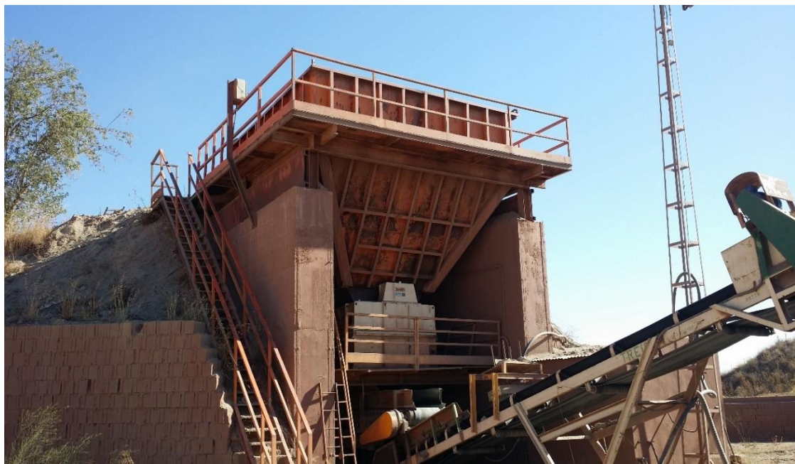
Fotografía 21. Tolva de 50 m3 de capacidad
