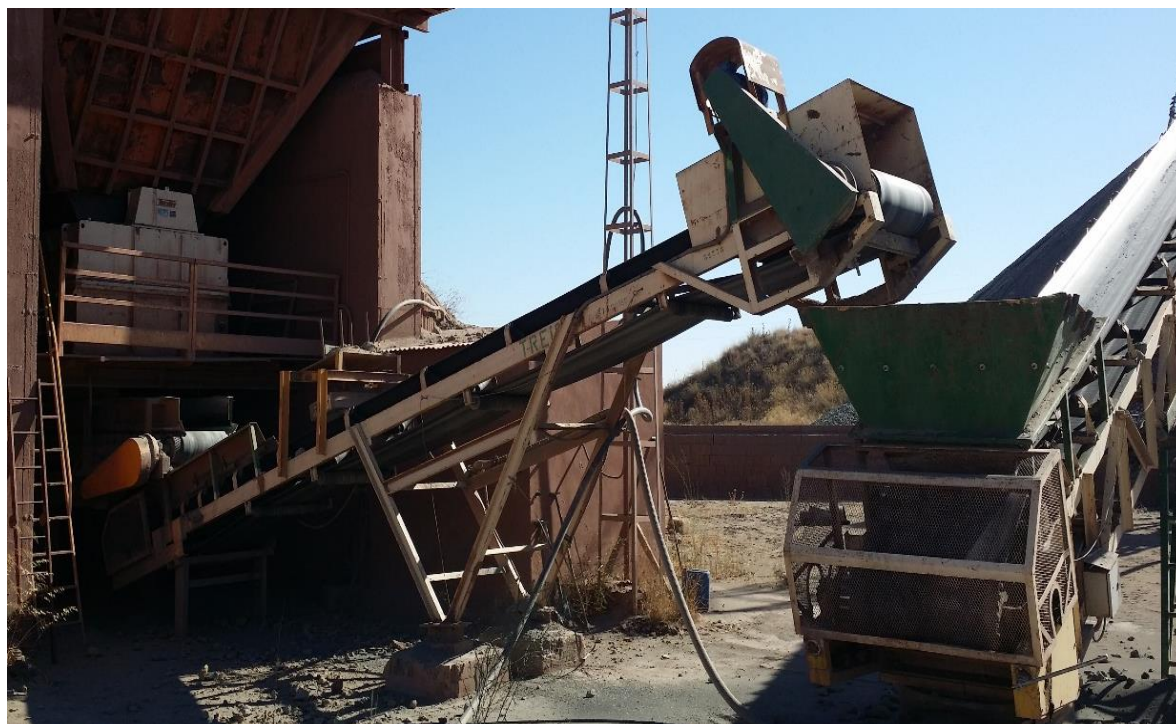
Fotografía 31 . Transportador de banda
