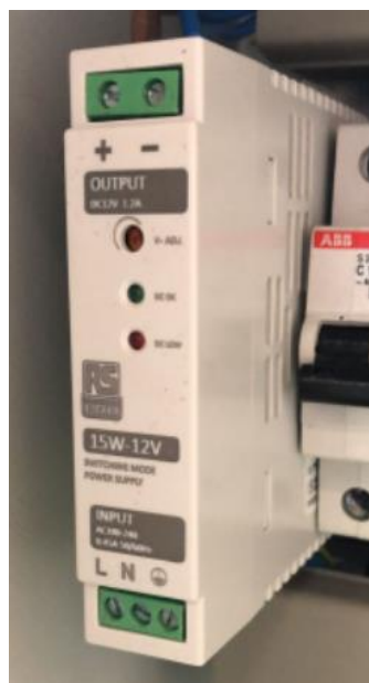
Figura 55. Fuente de alimentación del variador.
