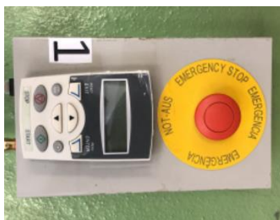
Figura 56. Mando de control del variador.
