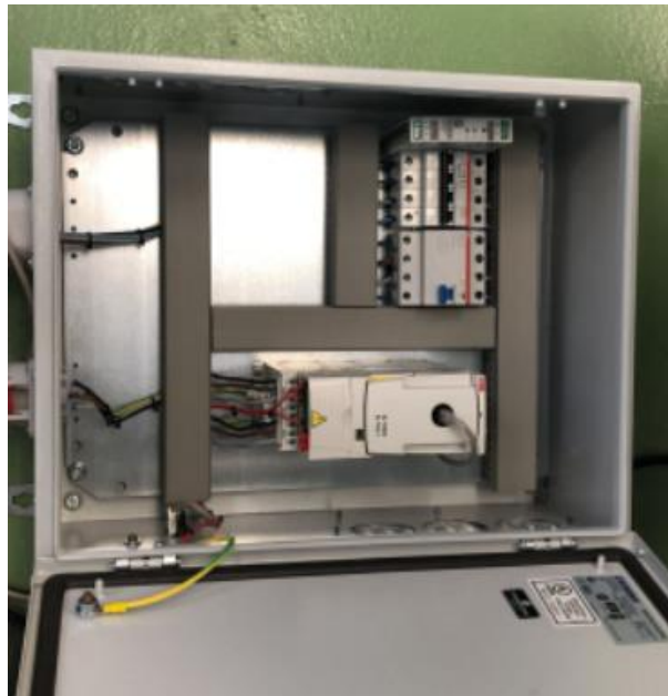
Figura 53. Variador de frecuencia.
