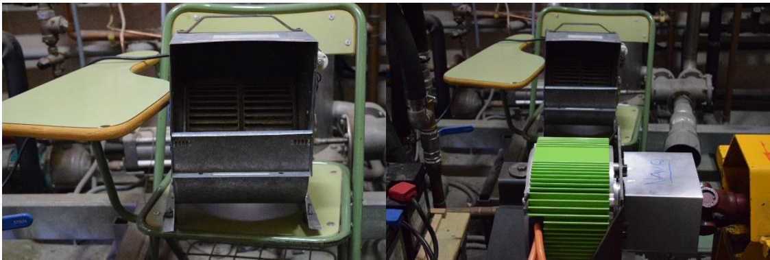
Imagen 45 Ventilación del motor. Fuente: Elaboración propia.
